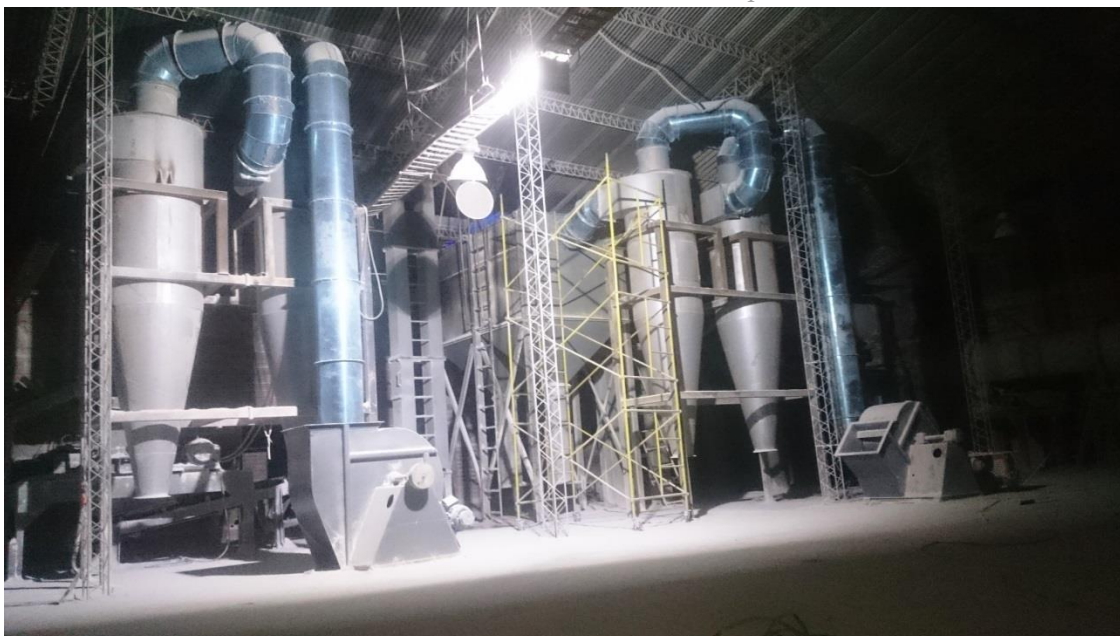
Infocal 25 extractoras Inox con extraccion de grasa/ gimancio con aire acondicionado
